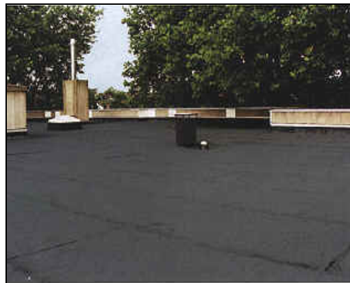
Alte Flachdächer weisen oft mehrere Lagen teerhaltiger Dachpappen auf.
