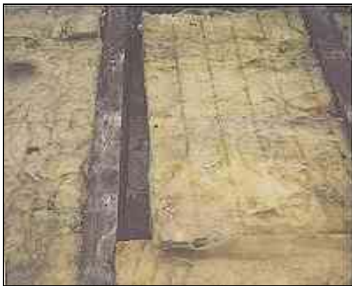
Beim Ausbau und bei der Entsorgung alter Mineralwolle sind besondere Vorsichtsmaßnahmen zu berücksichtigen.
